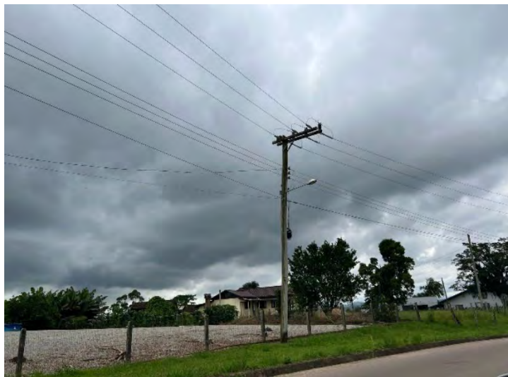
Figura 04 - Postes de energia elétrica e telefonia
