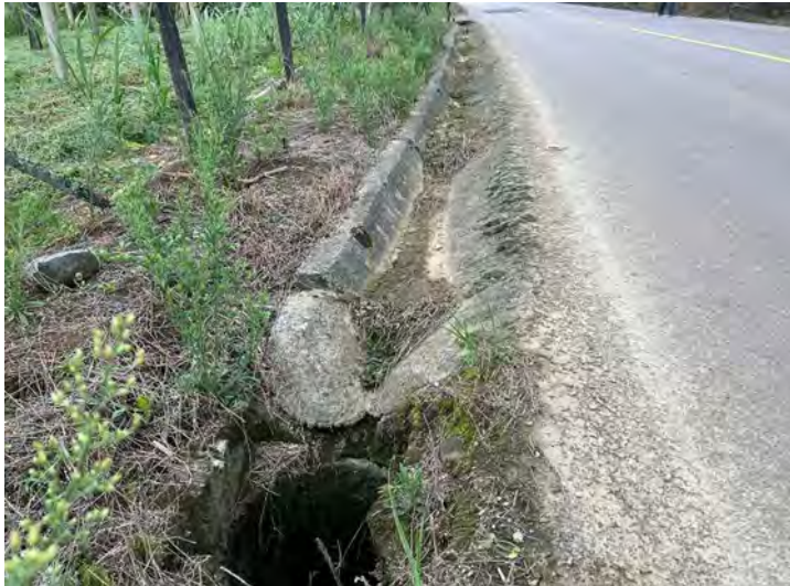
Figura 06 - Coleta de água pluvias em frente ao empreendimento
