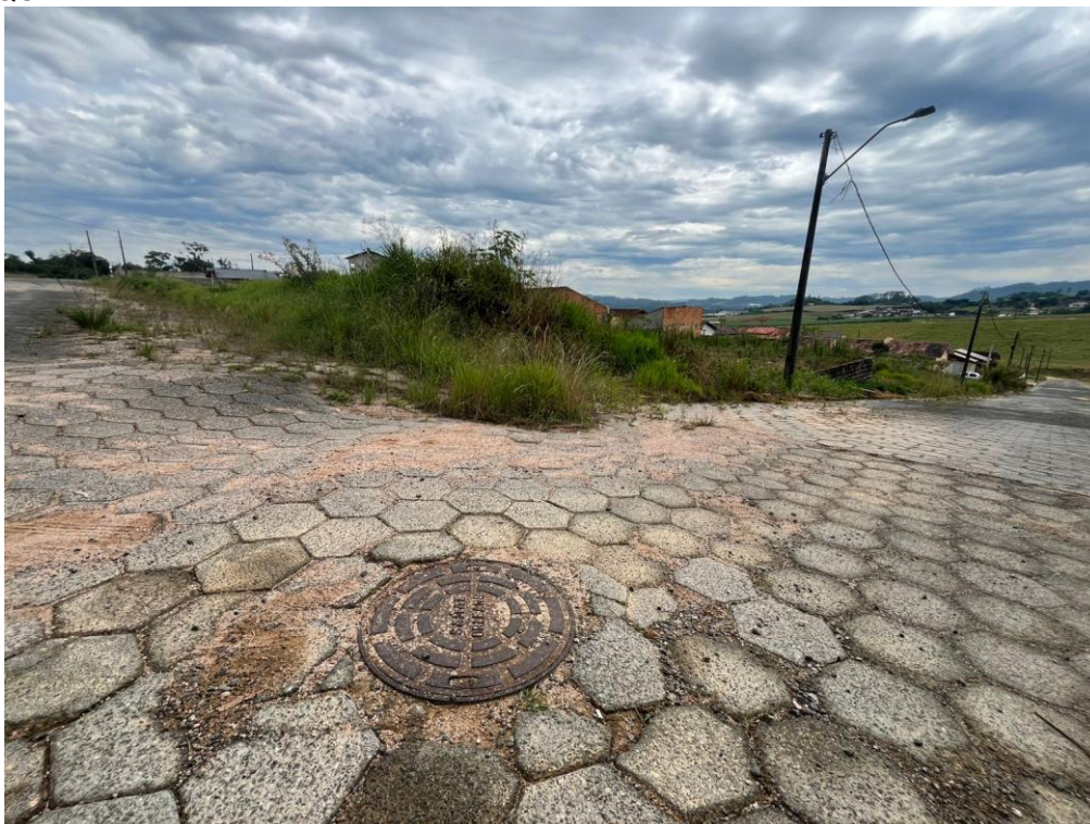
FIGURA 11: VISTA DO POÇO DE VISITA EXISTENTE NO TRECHO FINAL DA RUA ELIAS BONETTI, EM FRENTE AO IMÓVEL ONDE SE PRETENDE INSTALAR O LOTEAMENTO PARQUE DAS PALMEIRAS.
